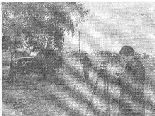
In der Zone der Neulandsowchose des Gebiets Omsk errichtet man die staatliche Irtysh-Wasserleitung, die 1 010 Kilometer lang sein soll. Unser Bild: der Leiter eines Forschungsgruppen W. Bindewald bestimmt die Baustelle der Pumpenstation für die Zentralsiedlung des „Rosowski“-Sowchos.
