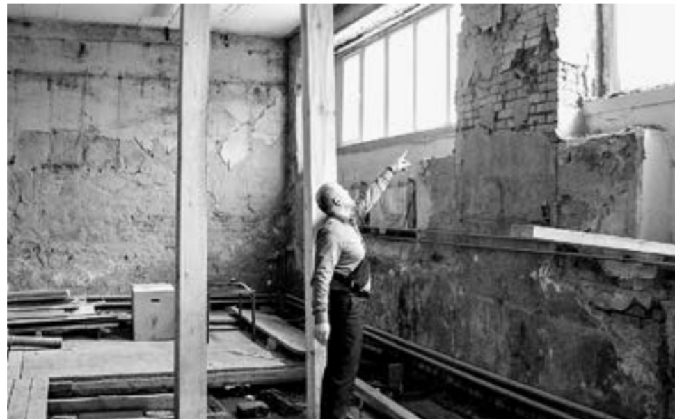
Алексей Семёнов показывает разрушающуюся стену.
