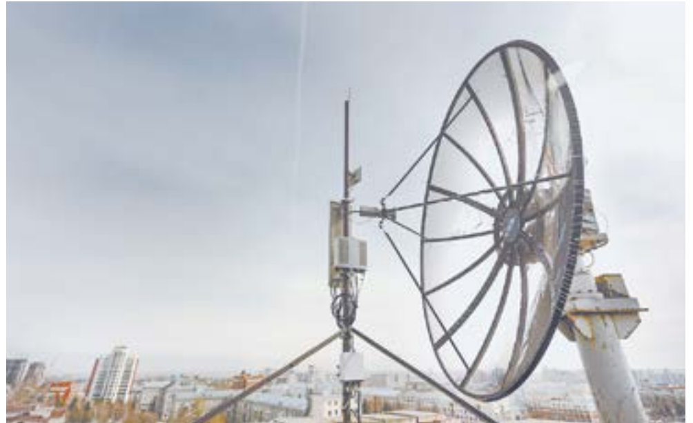
Земная спутниковая станция на крыше АлтГУ.
