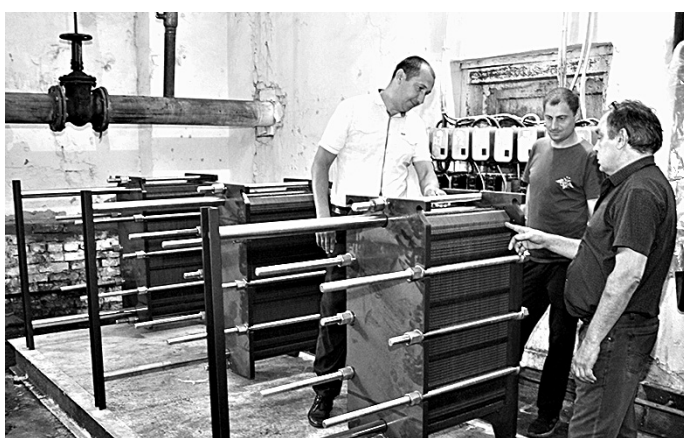
Новые теплообменники позволяют экономить ресурсы.
