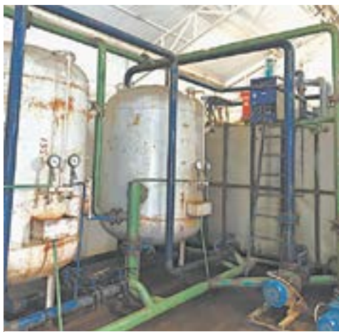
На водоочистительной станции.
