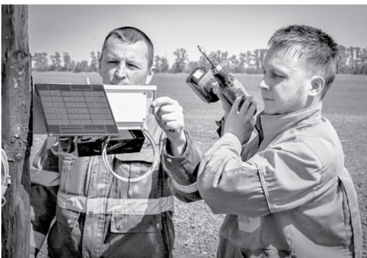
Метеостанцию устанавливают в поле на столбе.
