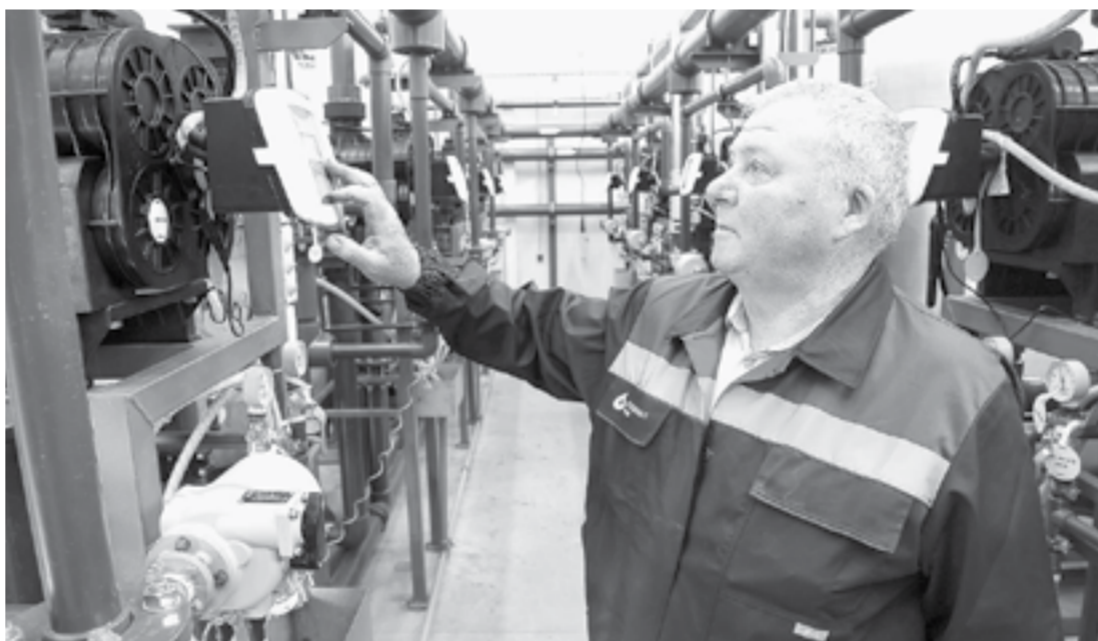
Внутри водоочистительной станции.
