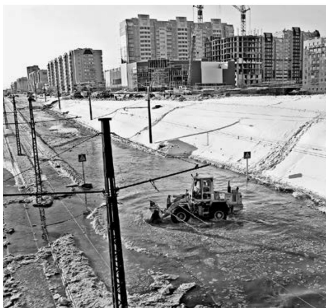
Износ коммунальных сетей в городских условиях приводит к особенно заметным ЧП.
