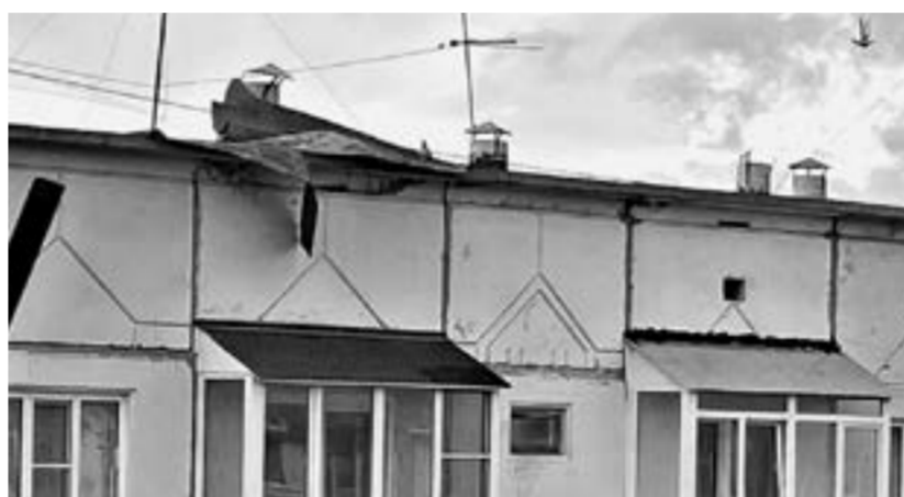
Поврежденная крыша в Рубцовске.
