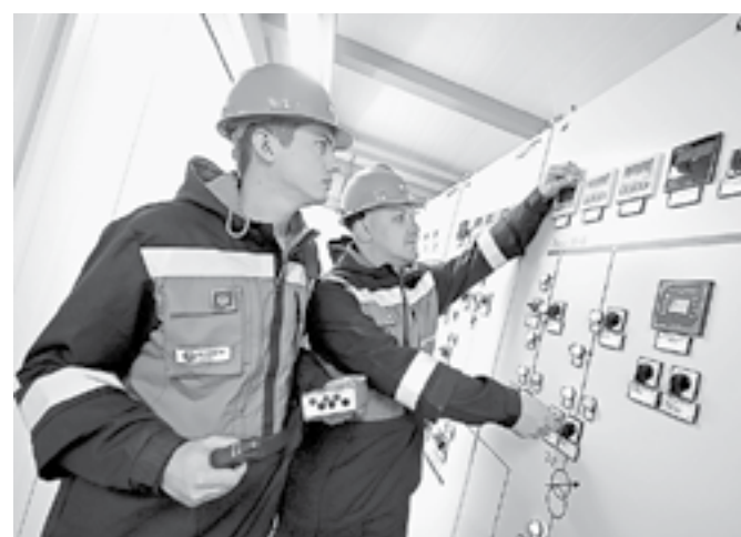
У подстанции появится возможность удаленного управления.
