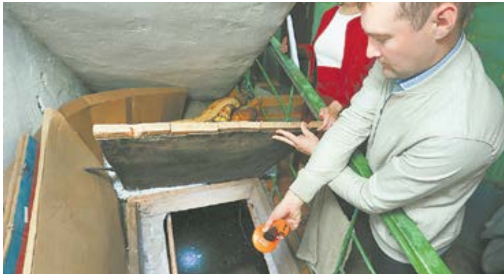
Вода все время в подвале.
