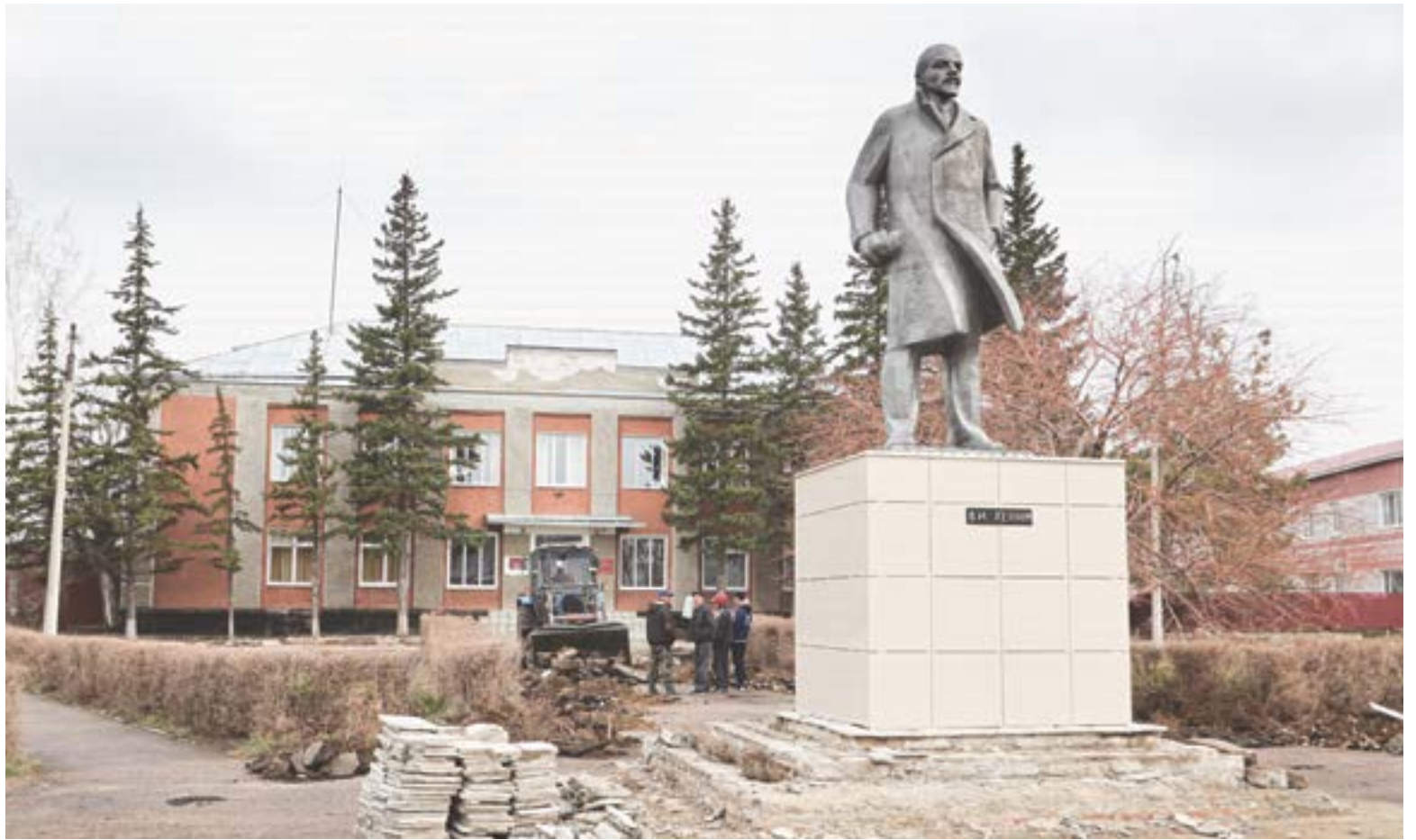
Площадь не видела капитального ремонта почти 40 лет.
