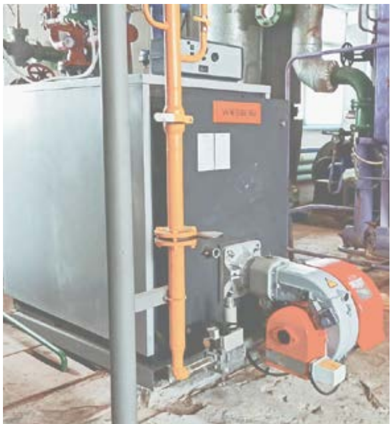
Новый газовый котел.
