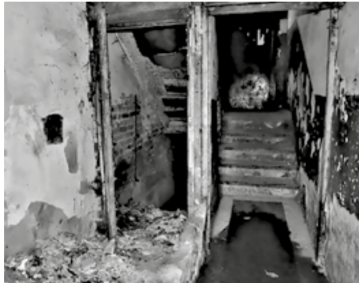
Стены в первом подъезде отсырели и рушатся.
