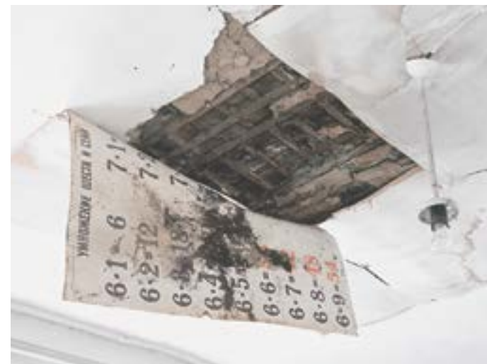
Своими силами сельчанам не справиться с ремонтом кровли.
