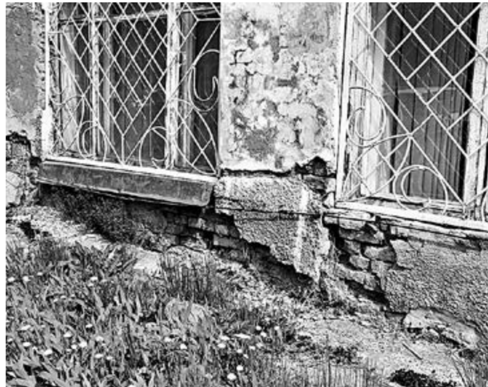
Здание Зональной ЦРБ признано аварийным, но до сих пор используется по назначению.
