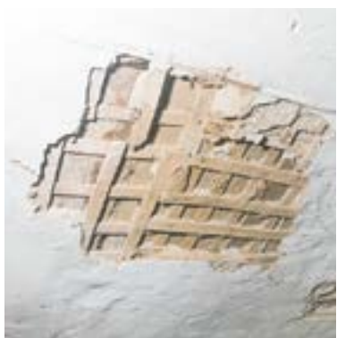
Стены в трещинах и потолки с падающей штукатуркой – суровая реальность сельского ДК.
