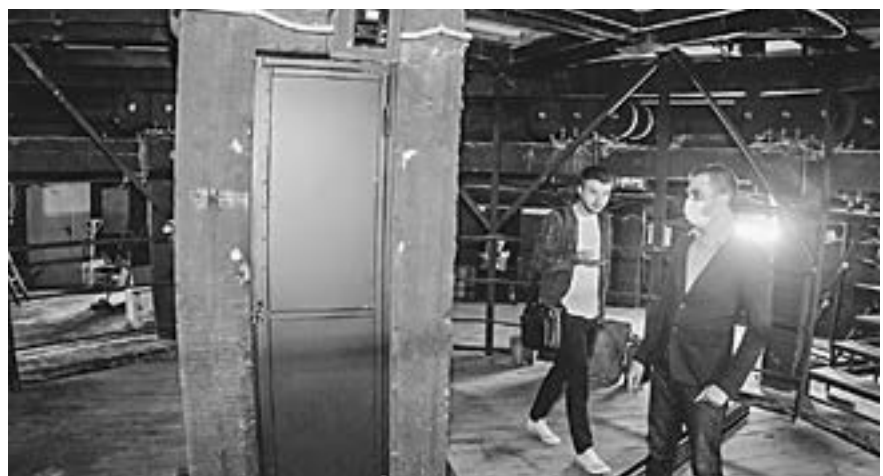
Под сценой скрыты обновленные механизмы поворотного круга и кольца.
