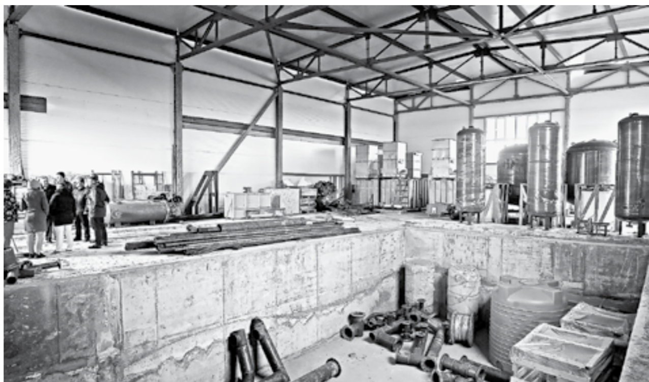
В помещении цеха водоочистки.
