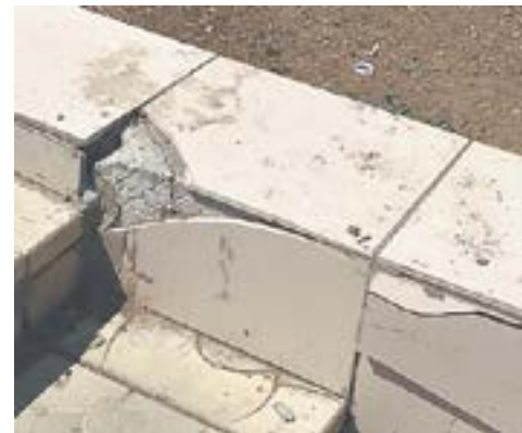
Осыпавшаяся плитка на площади восстановлена лишь на словах.
