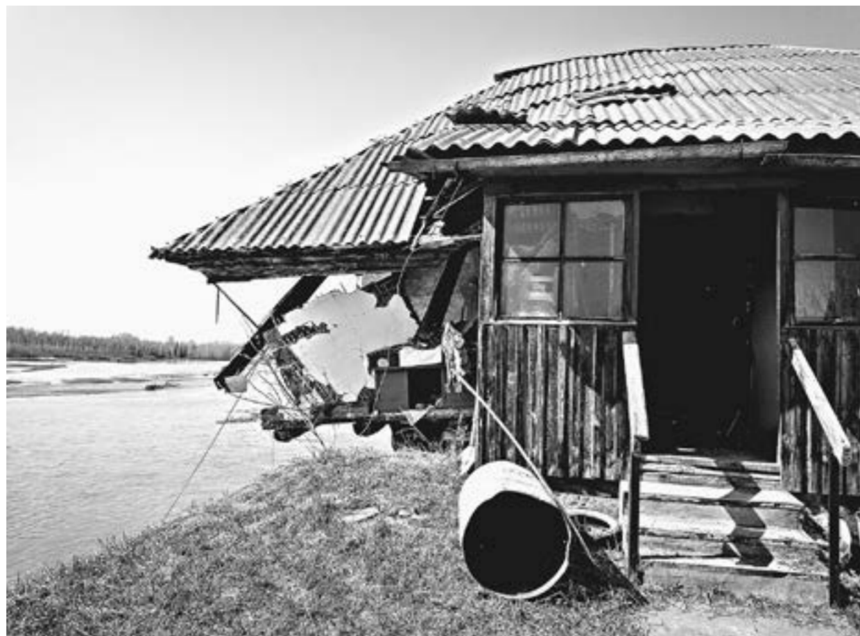
Медленно, но верно Катунь уже рушит постройки.
