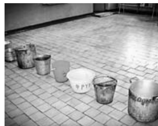
Вместо кровли – тазы и ведра.
