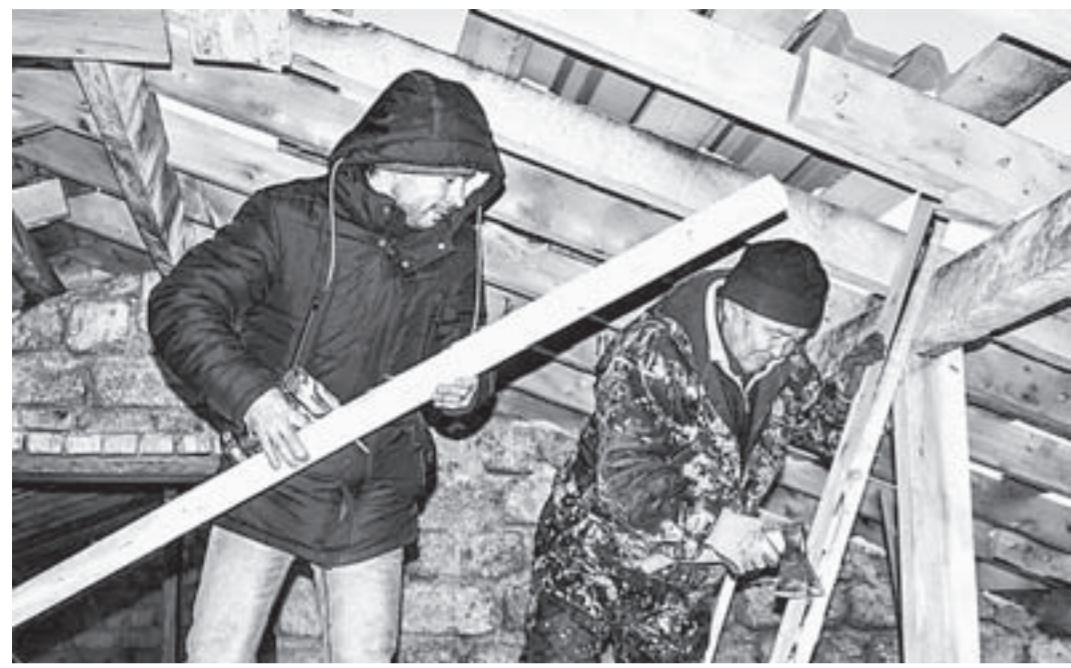
Теперь ремонта одной лишь кровли недостаточно.
