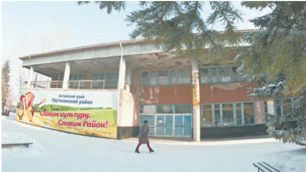
Старый Дом культуры нуждается в реконструкции.
