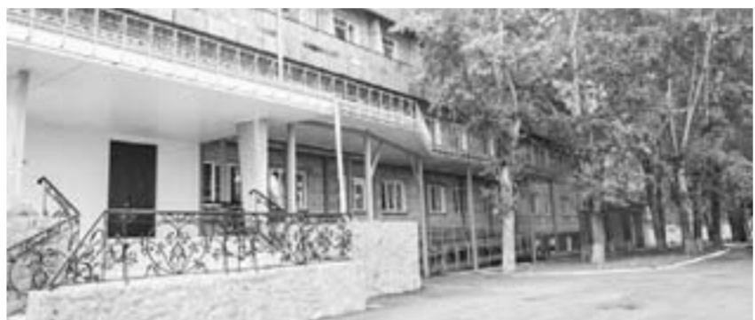
Фасад санатория нуждается в ремонте.
