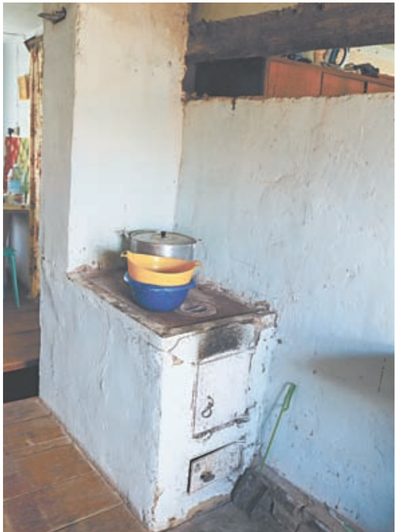
Печь треснула, дом требует ремонта.
