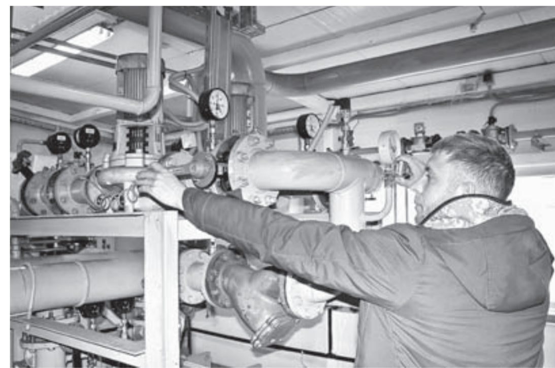
«Котел работает автоматически, но можно при необходимости и вручную регулировать», — объясняет начальник участка эксплуатации и ремонта газового оборудования ООО «Научный городок» Александр Положенко.
