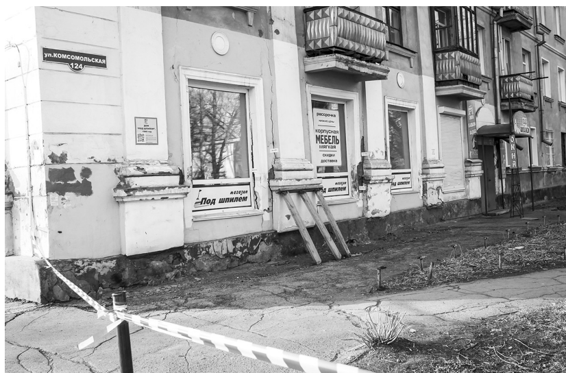
Подпорки уже не спасают аварийный дом.
