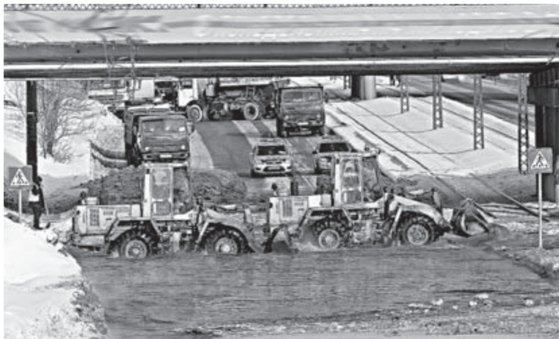
Идет устранение аварии на улице Малахова.
