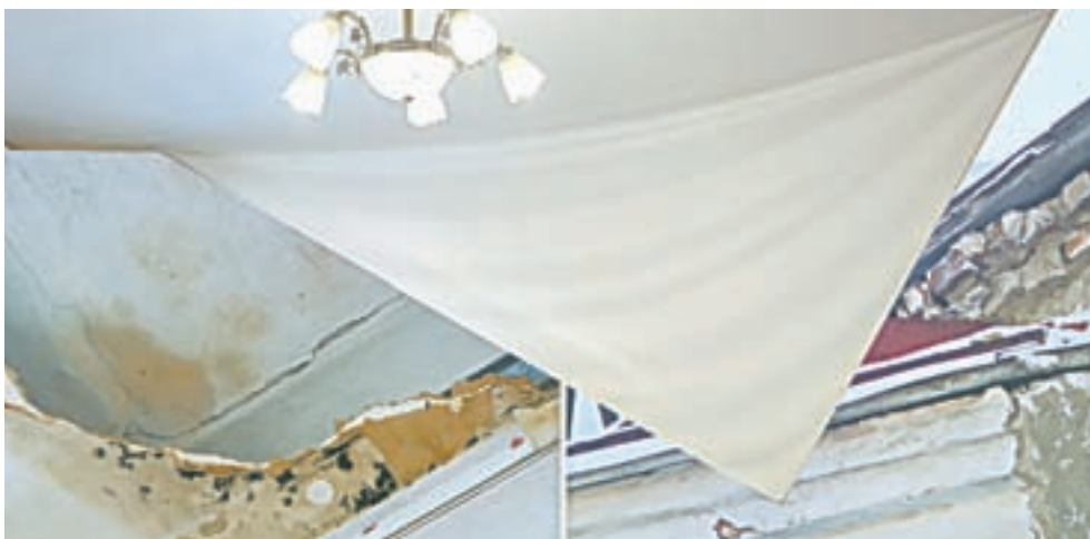
Крыша продолжает оставаться в аварийном состоянии.
