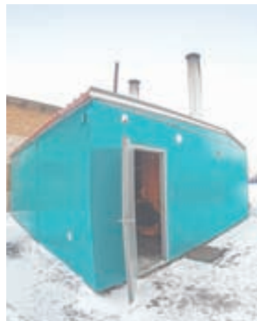
Новая котельная обошлась в 15 млн рублей.
