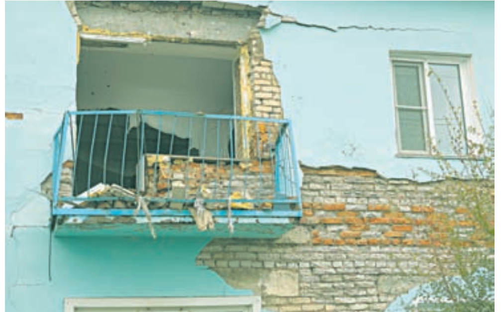
Взрывной волной вынесло балконный блок в квартире № 7.
