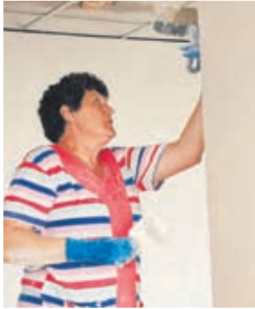
Лариса Полухина, штукатур-маляр с 30-летним стажем, приехала на ремонт Корниловской школы из Бийска. У нее большой опыт работы на объектах образования и здравоохранения.
