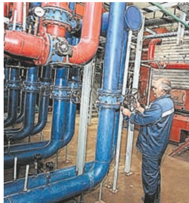
В котельной – самое современное энергоэффективное оборудование.
