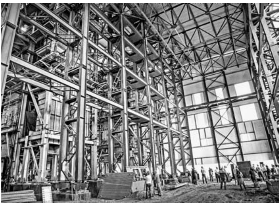
В котельном цехе ТЭЦ ОАО «Кучуксульфат» установили котлы производительностью 65 тонн пара в час давлением 40 атмосфер.
