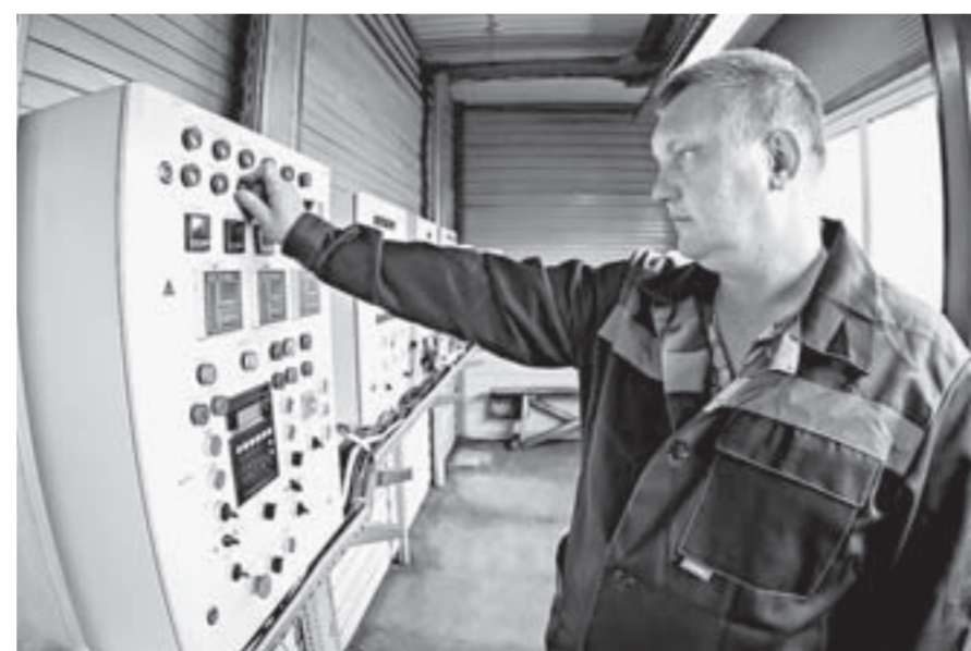
Современную котельную невозможно представить без электронного контроля.
