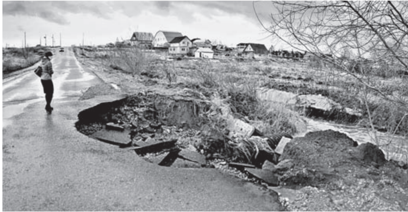
Разрушенная дорога опасна для водителей.
