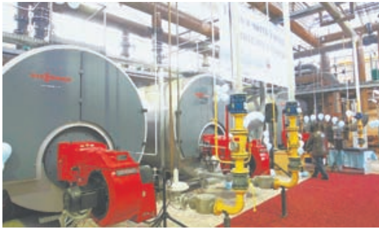
Новая газовая котельная в Бийске.
