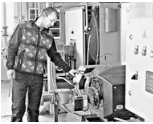
Газовую котельную с угольной не сравнить.
