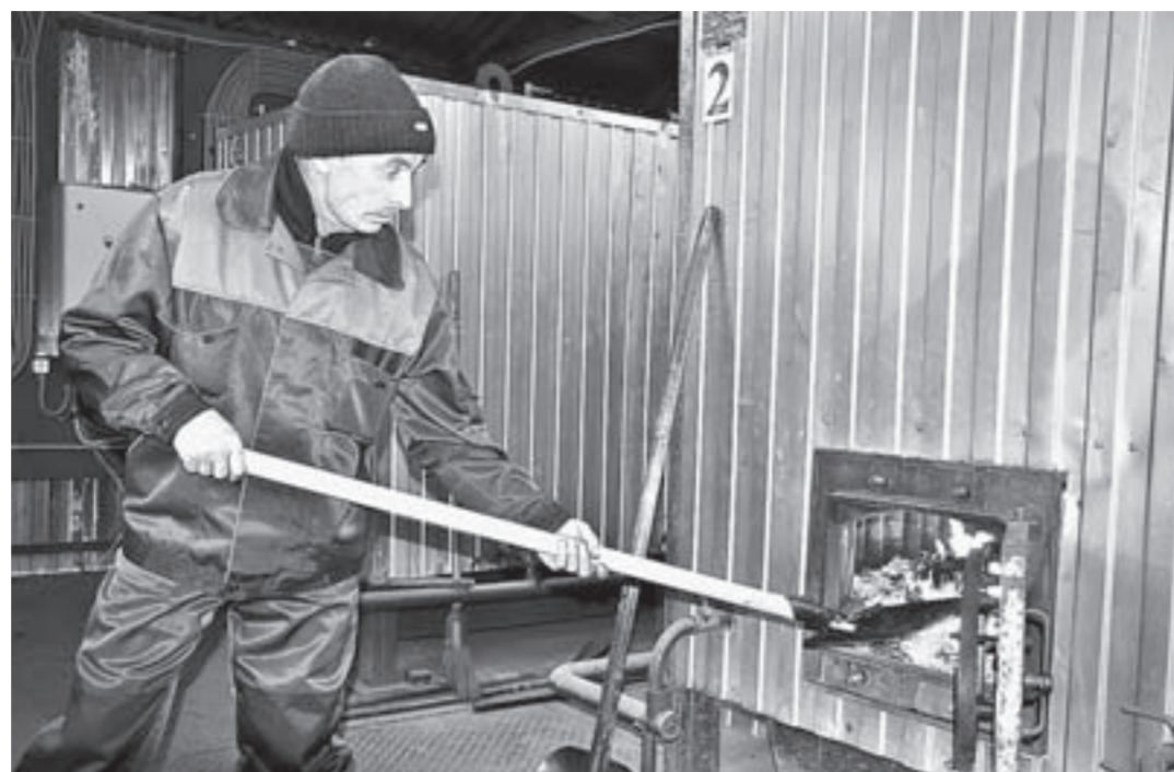
За 12 часов работы кочегар Николай Нефедов закидывает в топку 1 – 2 тонны угля.
