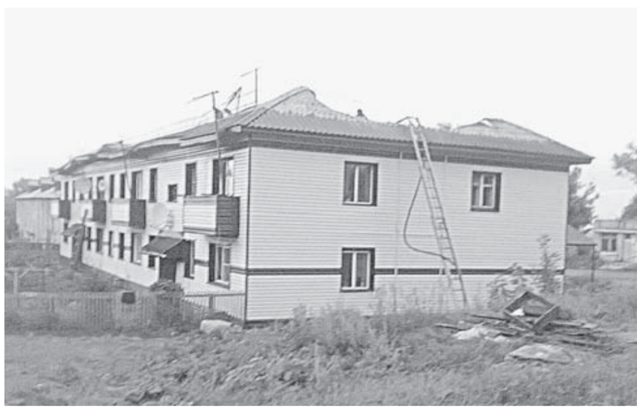
Обновленная крыша почти полностью разрушена.
