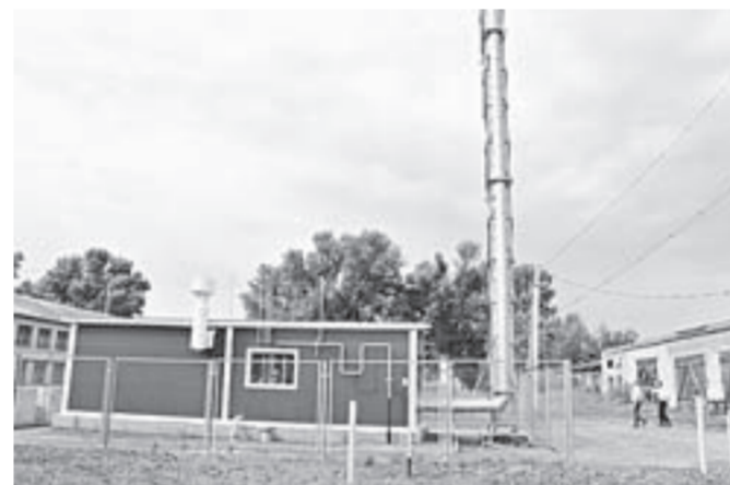
Эта автоматическая котельная будет отапливать школу.
