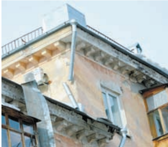
Водосточная труба разломилась на несколько частей.
