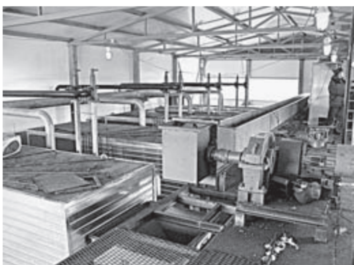
В котельной – новое, современное оборудование.
