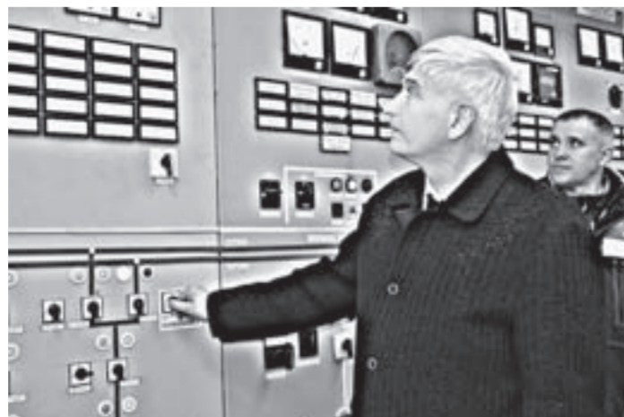
Виктор Мещеряков включает трансформатор.
