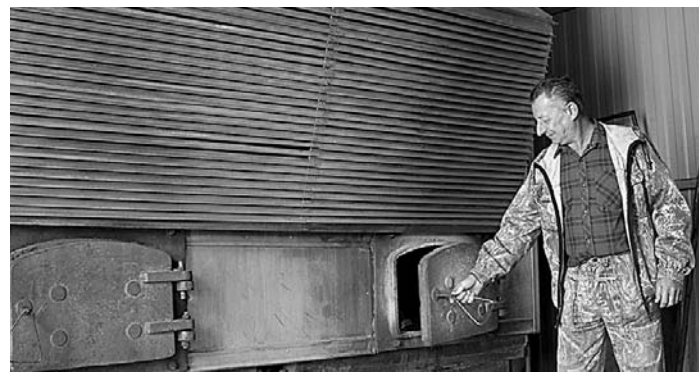
Машинист-котельщик модульной котельной Николай Твердохлеб.
