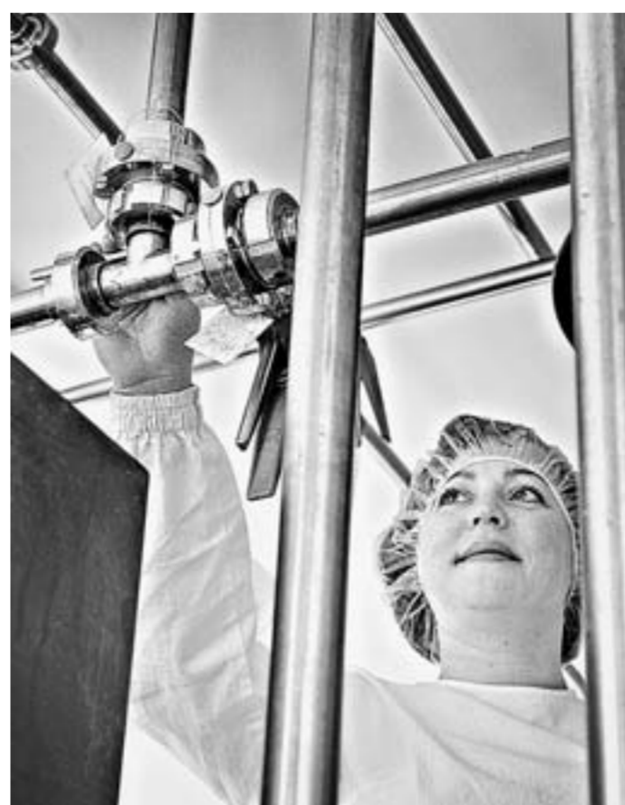
Оборудование из стекла и нержавеющей стали позволяет избежать дополнительных примесей в лекарствах и БАДах.
