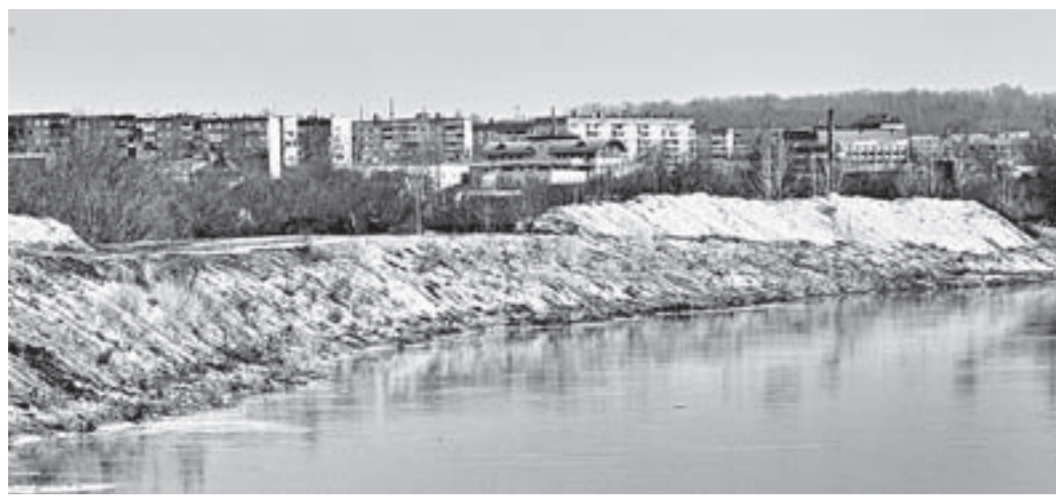
Работы по возведению дамбы в районе Зеленого Клина будут завершены к осени этого года.
