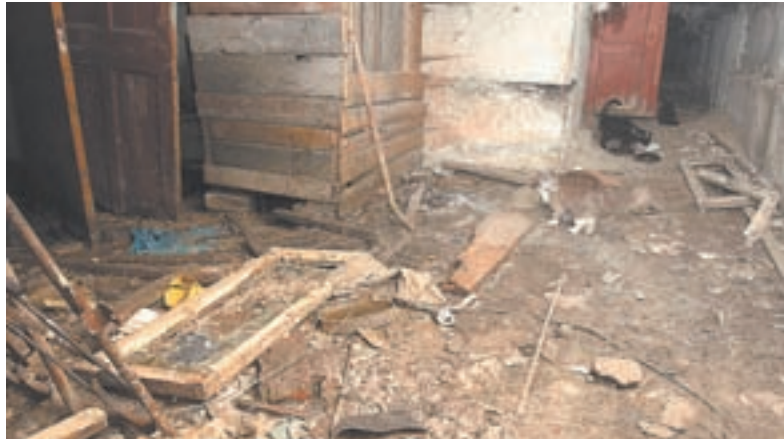
Состояние подвального помещения удручает.
