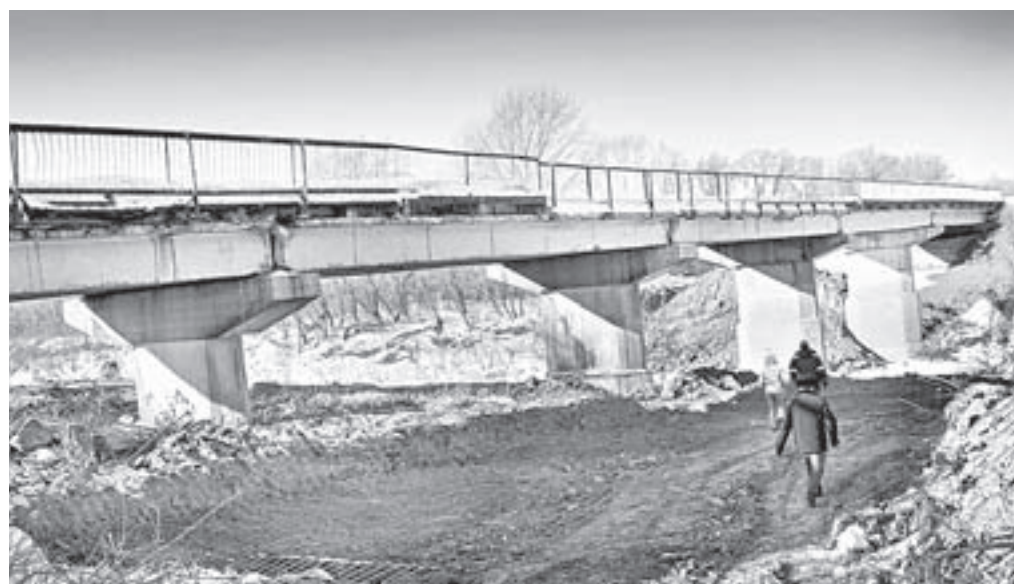
Издали не видно, что мост обветшал.
