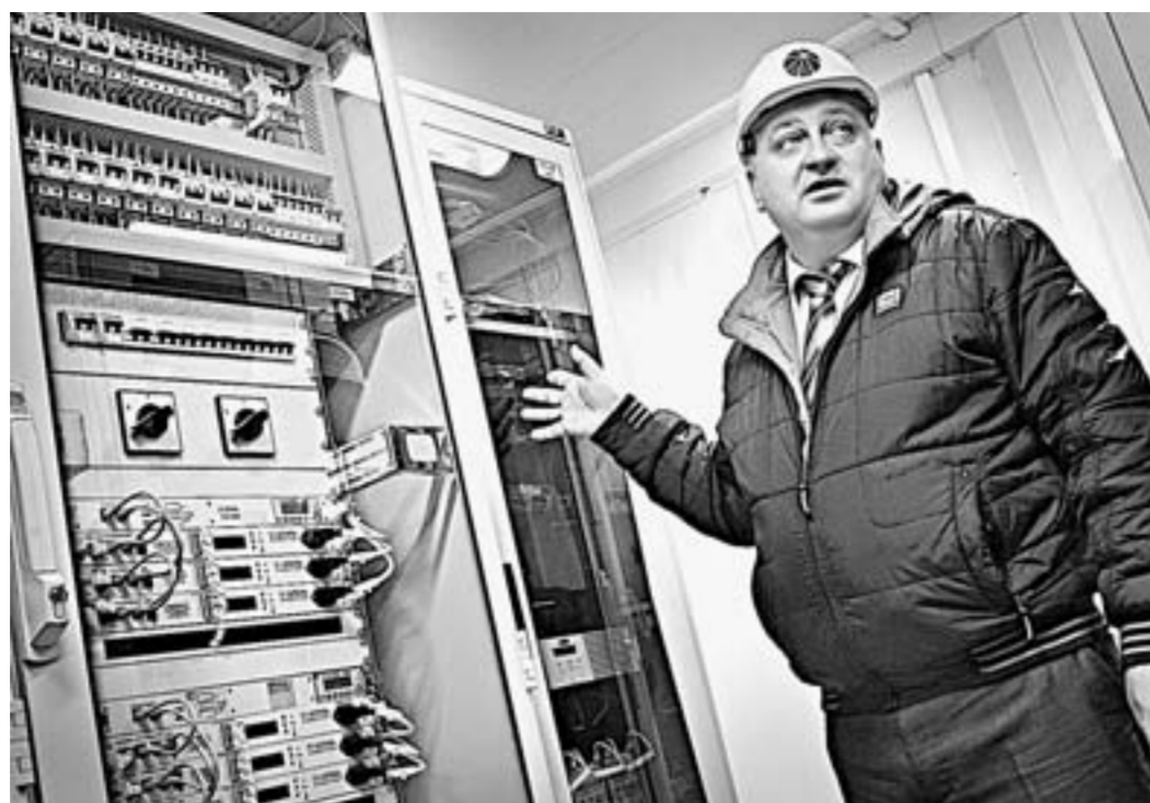
Николай Сычев: «Подстанция полностью автоматизирована».
