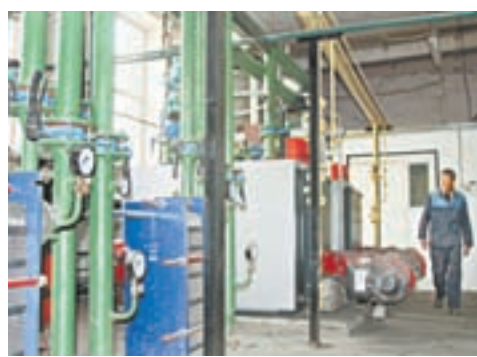
Газовая котельная, ул. Партизанская, 195-а.
